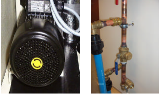
Kuva 13. Pumpun pyör.suuntanuoli ( vas. ), täyttöventtiilit ja täyttöpullo ( oik. )
